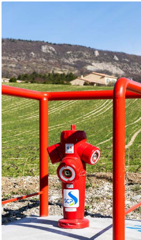
Exemple de bome destinée à la défense incendie installée dans la vallée du Jabron
